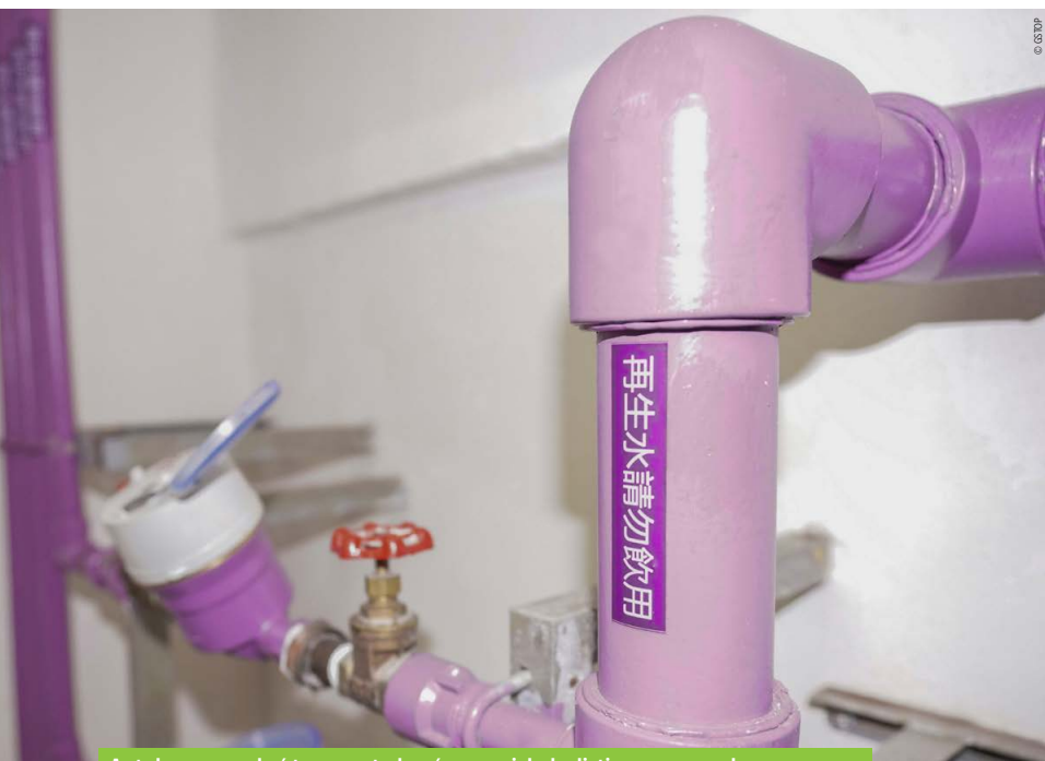
As tubagens onde é transportada a água reciclada distinguem-se pela sua cor roxa
